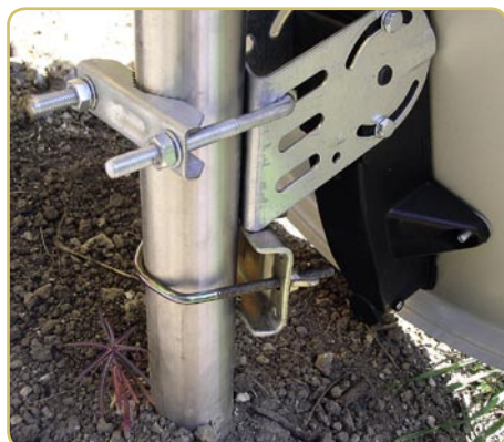
Un soporte extra de montaje para estabilizar el plato mientras se está ajustando
