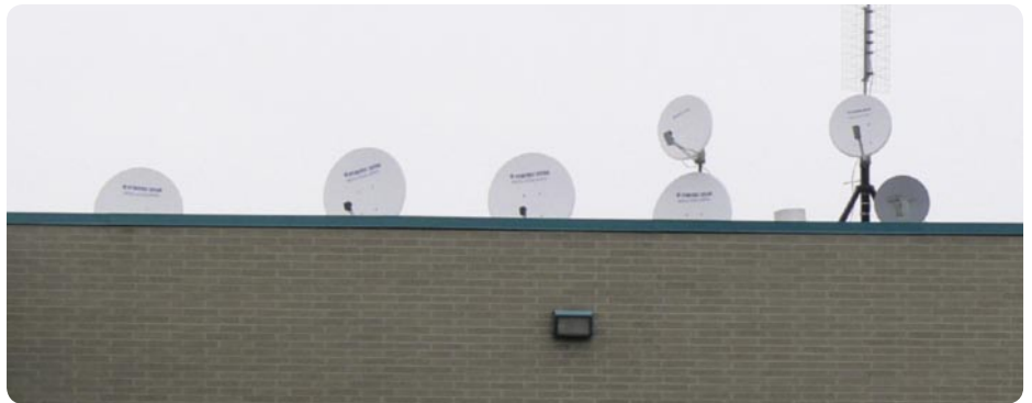
Los platos del satélite de Fortec Star están en el tejado y escasamente visibles. Los platos de la izquierda son de 90 centímetros uno de los cuales se opera con un motor de Stab HH90 y un receptor preprogramado Glorystar. La lista de canales se
