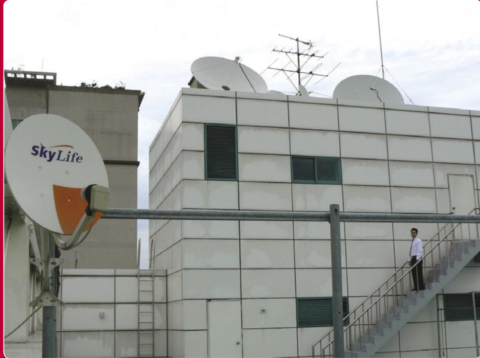
David Choi en el tejado del edificio de Topfield. Una antena pequeña puede verse a la izquierda para la recepción de SkyLife en el KOREA-SAT junto con otras antenas
